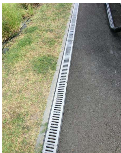
Figure 12 : Caniveau bordant les surfaces imperméabilisées.
