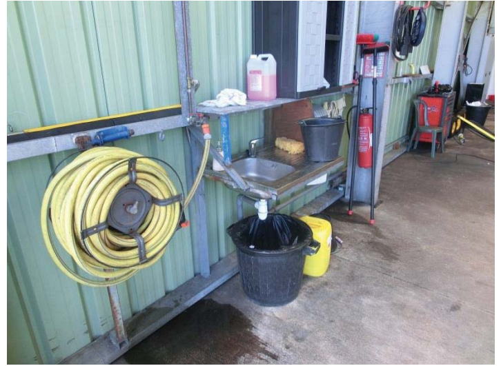
Figure 4 : Arrivée d'eau dans le hangar.
