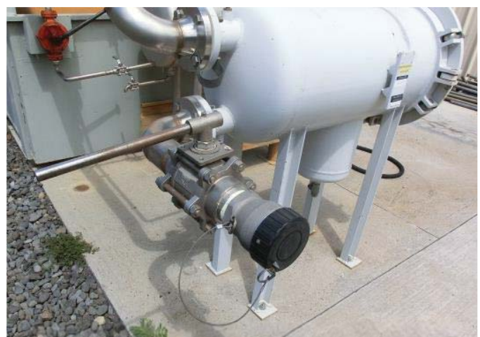
Figure 9 : Vue de la vanne de remplissage.
