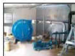
Pompe péristaltique dans local de protection
