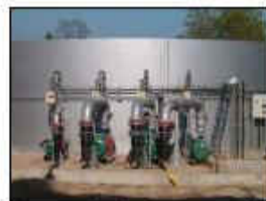
4 pompes de reprise des eaux recyclées
