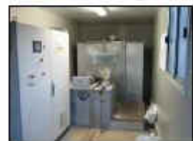
Vue générale de l'armoire électrique dans le bungalow technique
