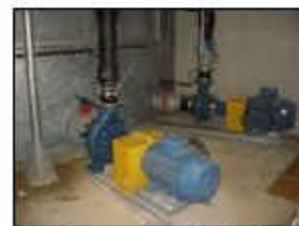
2 pompes de reprise dans local de protection
