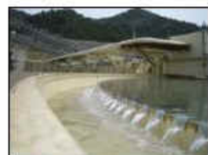
Coulée de débordement des eaux clarifiées
