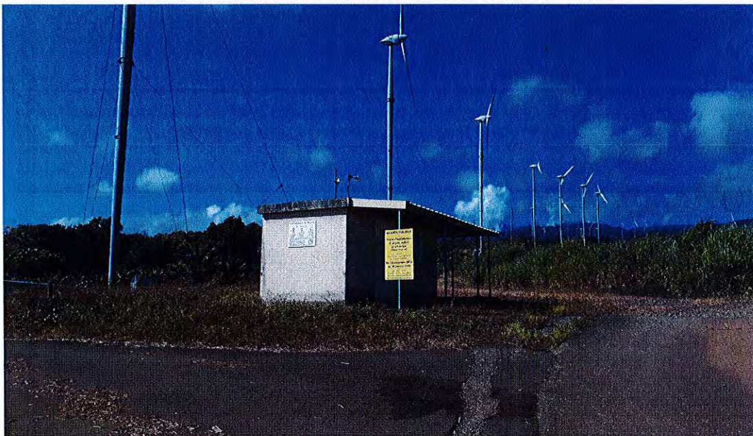
Panneau au poste de livraison
