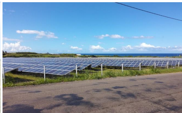
Le paysage énergétique, marqué par les panneaux photovoltaïques existants
