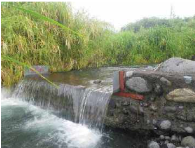
Figure 173 : Ouvrage en aval d'un « canal bichique » empêchant la remontée des poissons et crustacés en amont (© Biotope, 2015)
