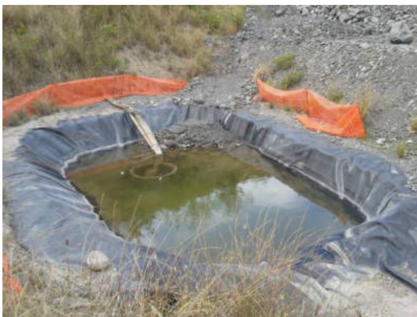
Figure 9 : Vue du bassin de rétention des eaux de la zone de stockage
