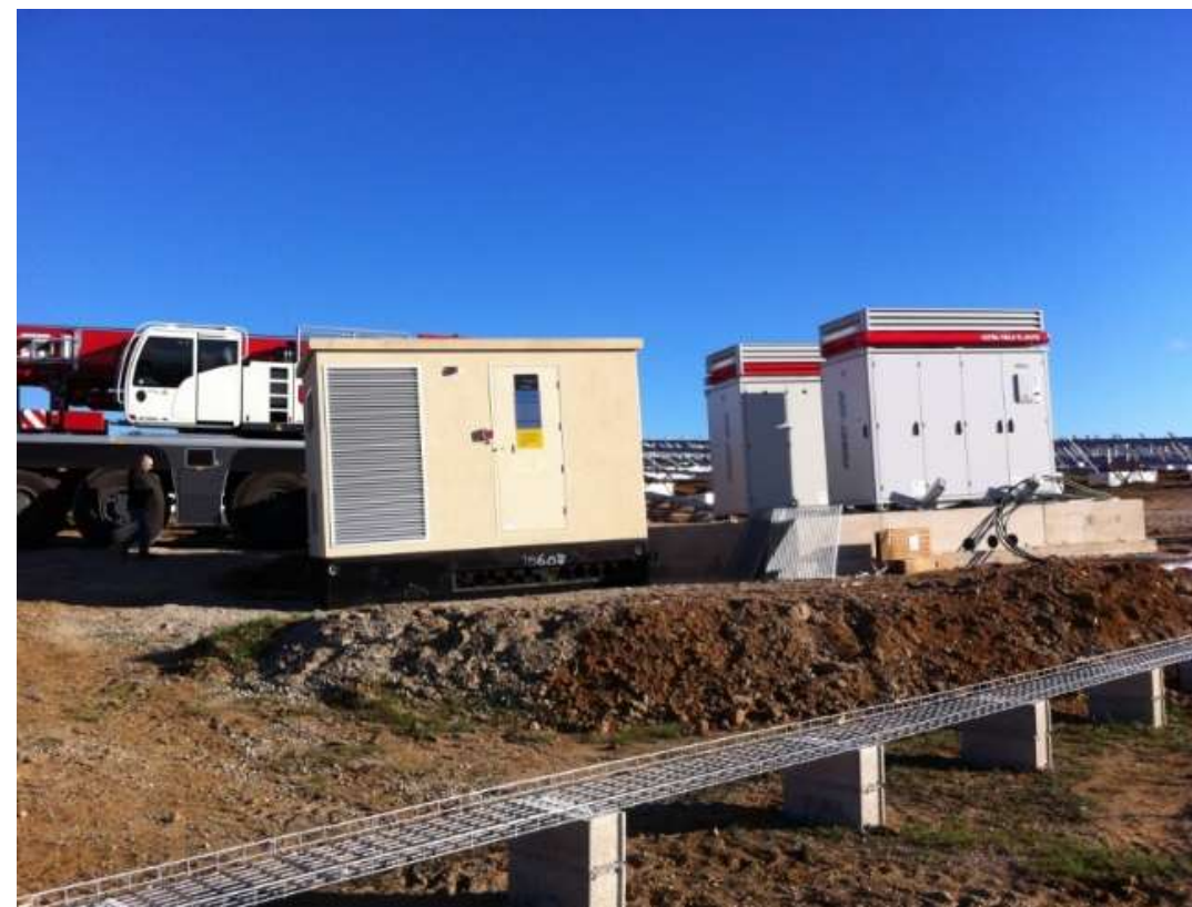
Figure 15 : Exemple de mise en place de locaux techniques (Source : TOTAL QUADRAN)
