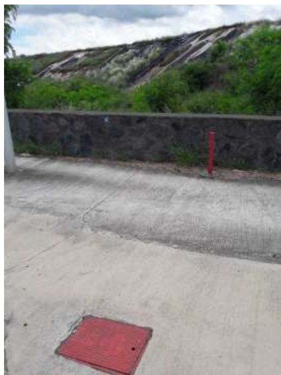
Figure 20 : Photographie de la bouche incendie permettant l'intervention du SDIS (Source : TOTAL QUADRAN)
