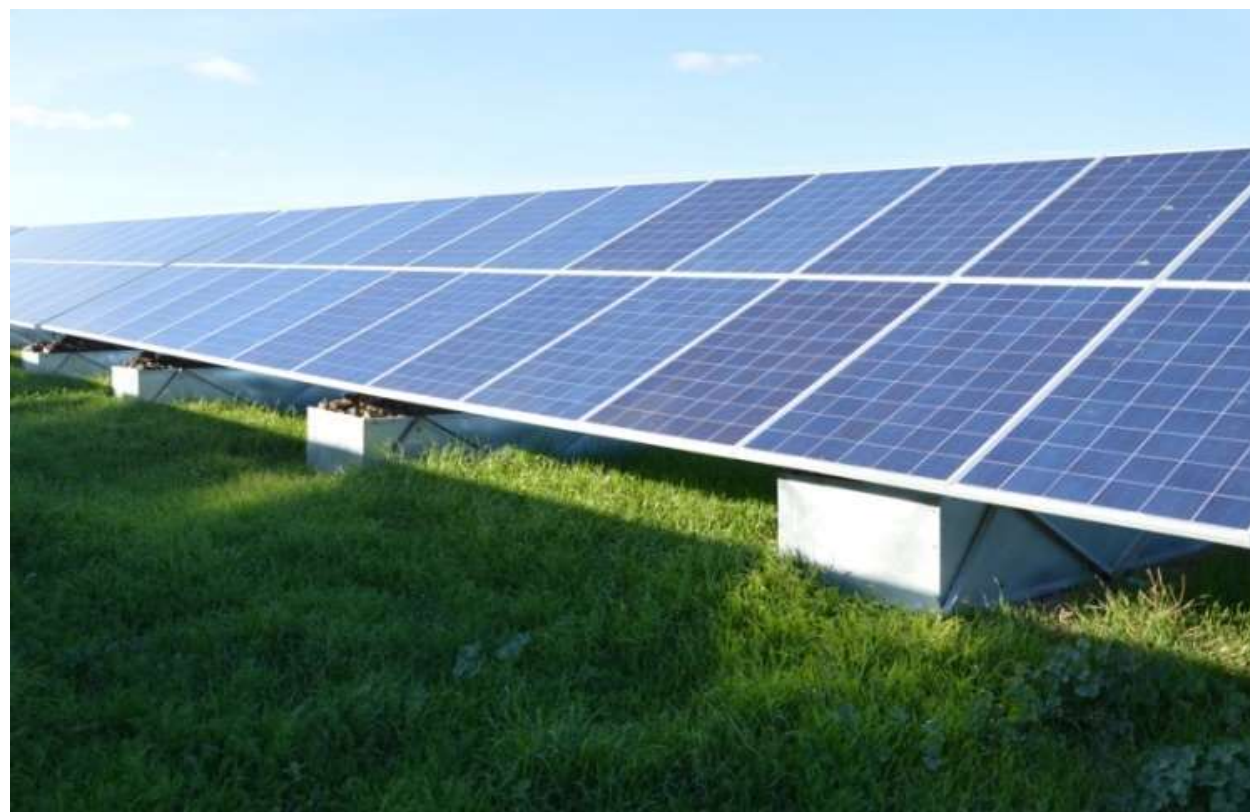
Figure 14 : Exemple de plots autoportants (Source : TOTAL QUADRAN)
