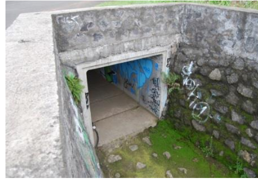
[E] Cadre 2m x 2m canalisant l'axe d'écoulement préférentiel de l'impasse Edouard Manes
