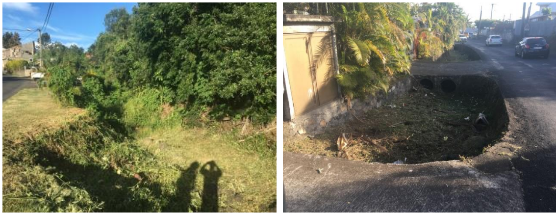
Figure 27 : Transparence hydraulique existante de la Ravine des Cabris, au droit du chemin Hermitage
