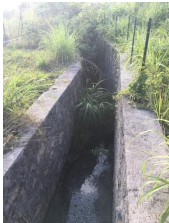
[B] Fossé bétonné existant en aval de la clinique Durieux (dimensions 2m x 1m)
