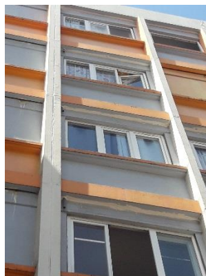
Figure 14 : interstices rebouchés au-dessus des fenêtres (Source : BIOTOPE)
