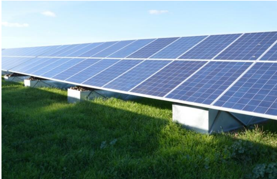
Figure 4 : Exemple de plots autoportants (Source : TotalEnergies)
