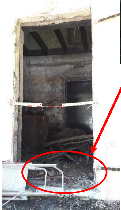
Guano au sol au Rez-de-chaussée
