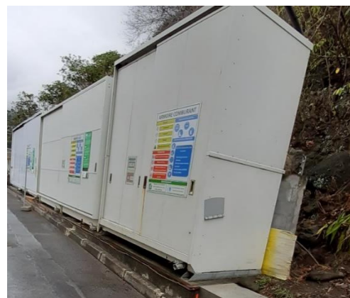
Nouvelles armoires chimiques
