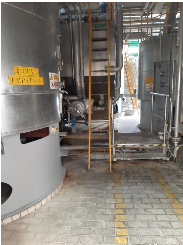
Cuve de préparation de bière - Brasserie
