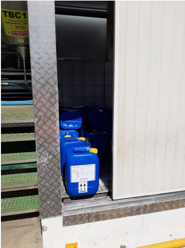
Armoires de stockage extérieures de produits chimiques
