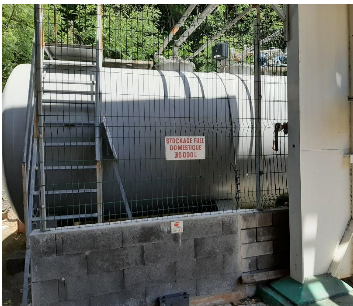
Cuve de stockage GNR
