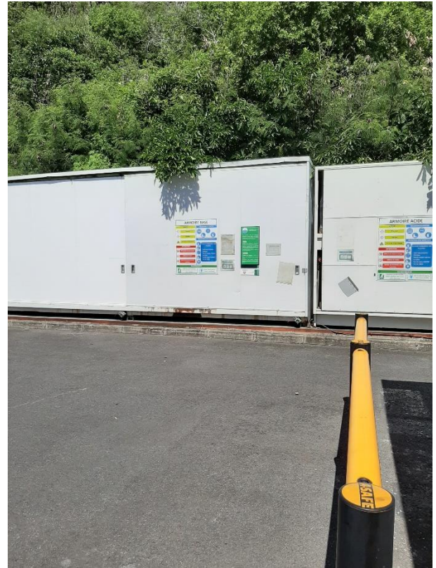
Armoires de stockage extérieures de produits chimiques
