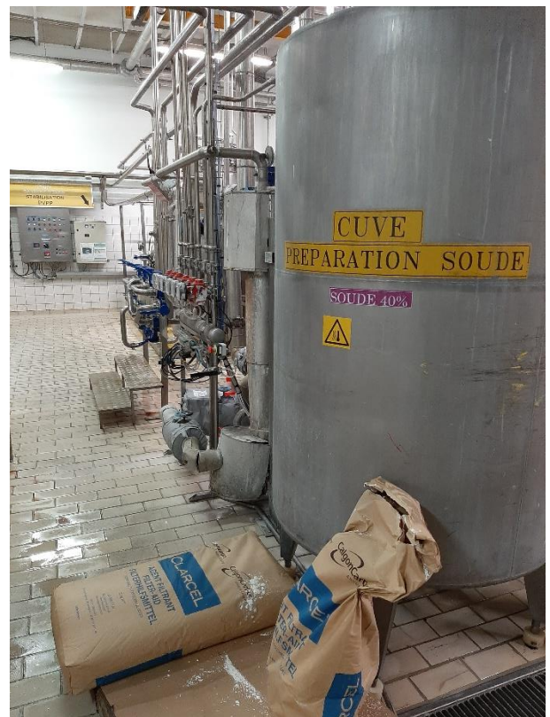
Cuve de préparation de soude - Brasserie
