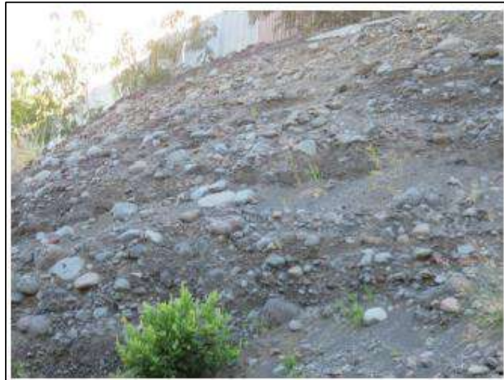
Planche 50 : Photographie d'alluvions sablo-graveleuses grises dans le talus au droit du sondage P1 (Source : Mascareignes Géologie)
