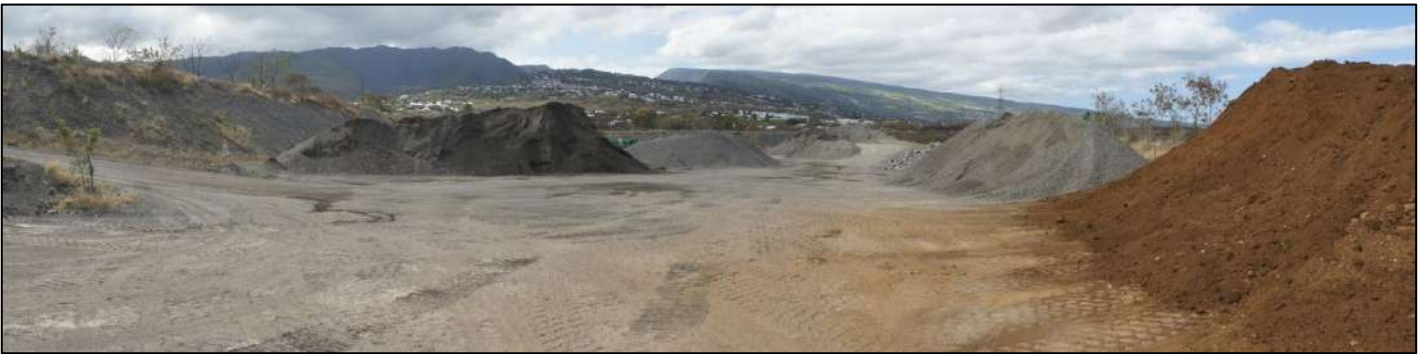
Planche 40 : Stock de matériaux et de terre végétale (pour la remise en état)
