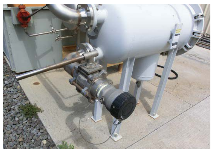
Figure10 : Vue de la vanne de remplissage.
