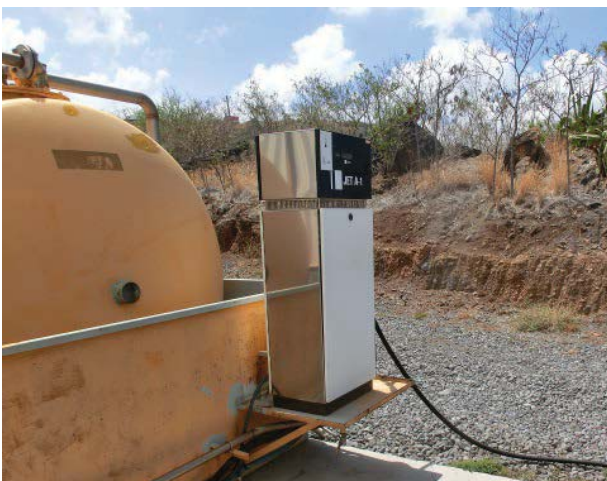
Figure9 : Vue de la pompe de distribution.
