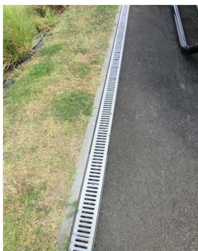
Figure 13 : Caniveau bordant les surfaces imperméabilisées.
