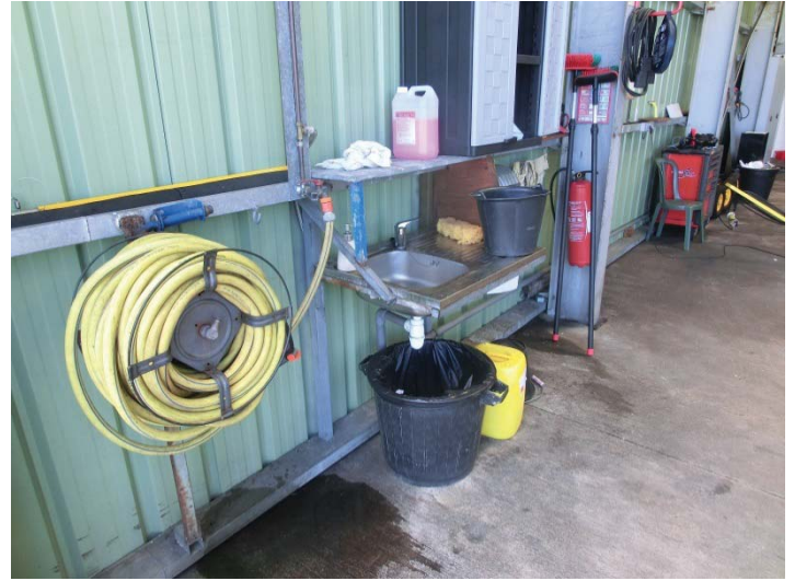
Figure 5 : Arrivée d'eau dans le hangar.
