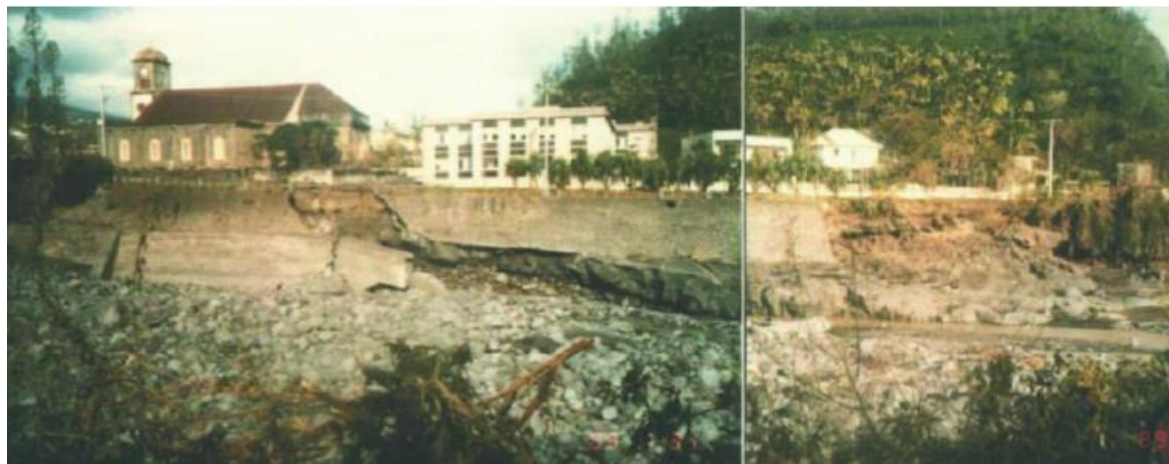
Erosion et affouillement de la digue de l'hôpital après le cyclone Firinga en 1989
