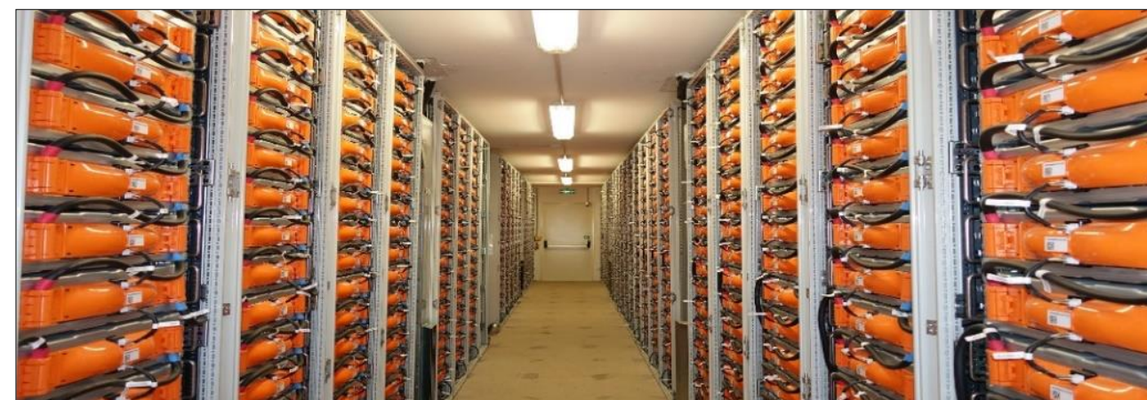
Figure 9 : Installation de stockage (Les Cèdres, 9MWh)
