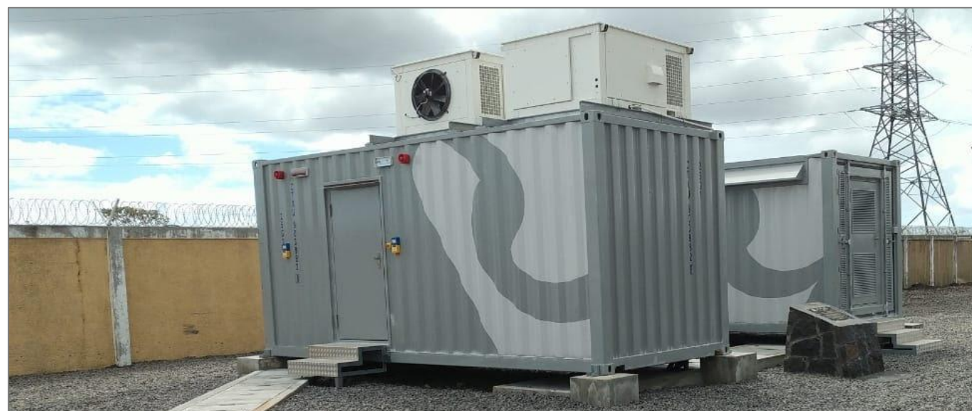
Figure 11: Installation de stockage dans un conteneur 20'
