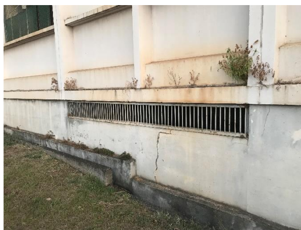
Figure 10 : Grille de sous-sol avec forte odeur de guano
