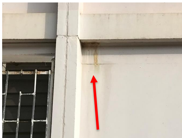
Figure 7 : Trace d'urine au niveau d'un joint
