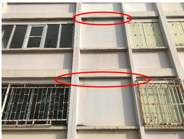
Figure 6 : Gîtes certains au niveau des interstices derrière les poutres béton – Bâtiment Z
